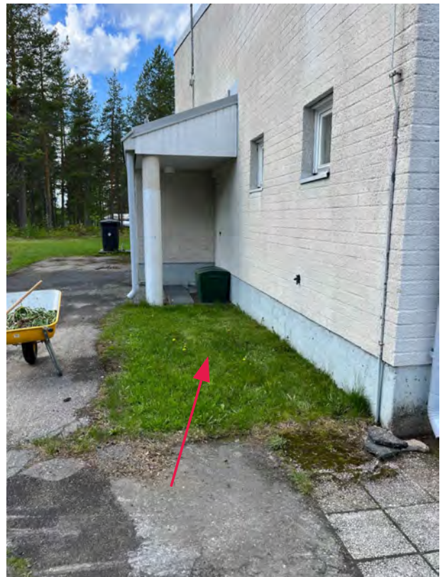
Kuva 8. Maanpinnan kallistukset heikot.
