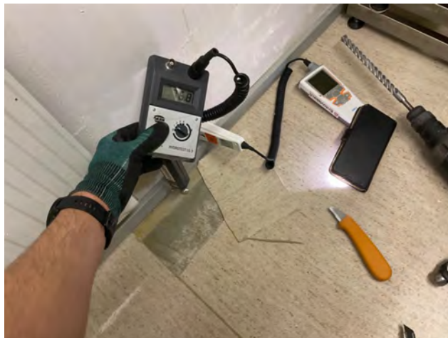
Betonin pintakosteuslukema 76,5 on hieman koholla
