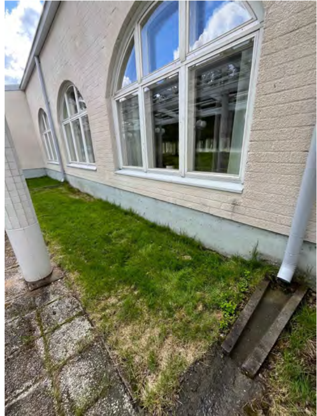
Kuva 6. Maanpinnan kallistukset heikot.
