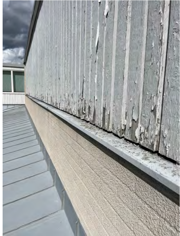
Kuva 26. Vesikatolla puuosien maalipinta heikko
