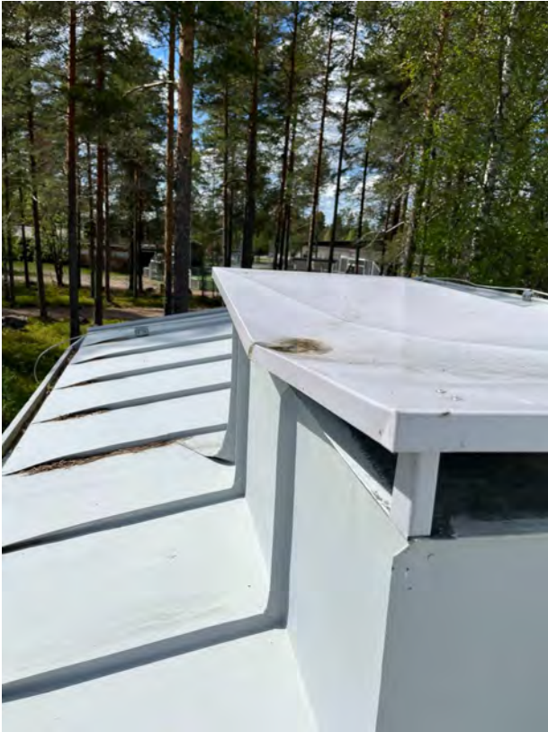
Kuva 25. Ilmanvaihdon kotelon hattu rikki
