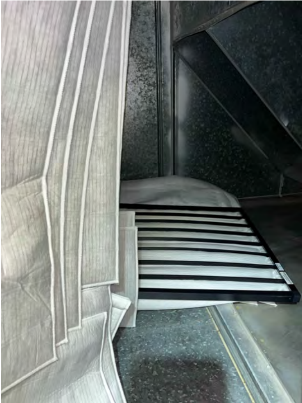
Kuva 2. Ilmanvaihtokoneen suodatin on irti
