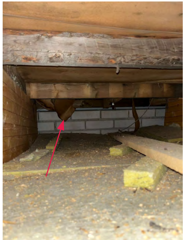
Kuva 28. Aluskate päättyy ulkoseinälinjan sisäpuolelle (huone nro 24)
