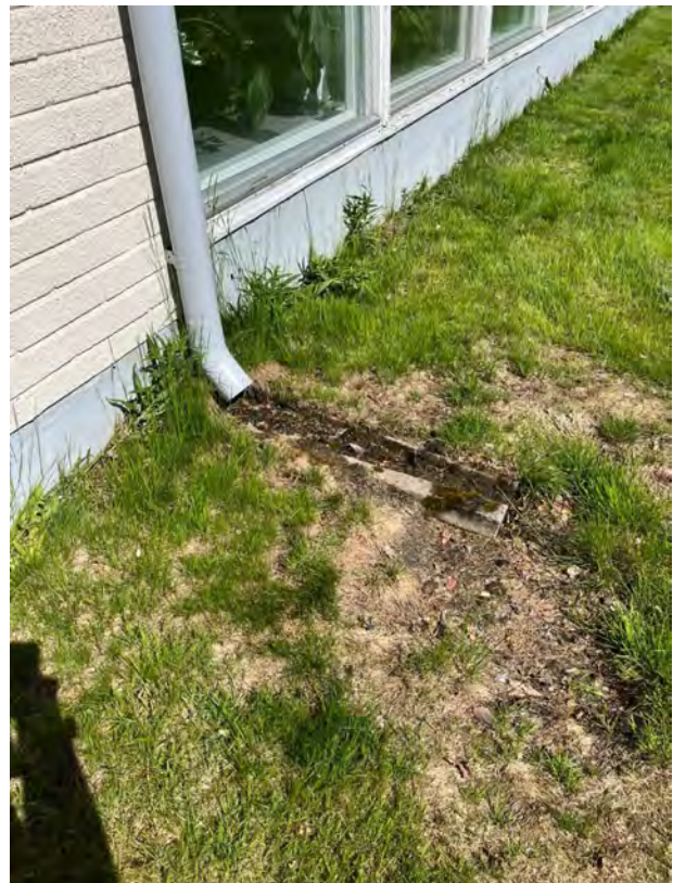
Kuva 16. Vesi lammikoituu seinän vierustalle
