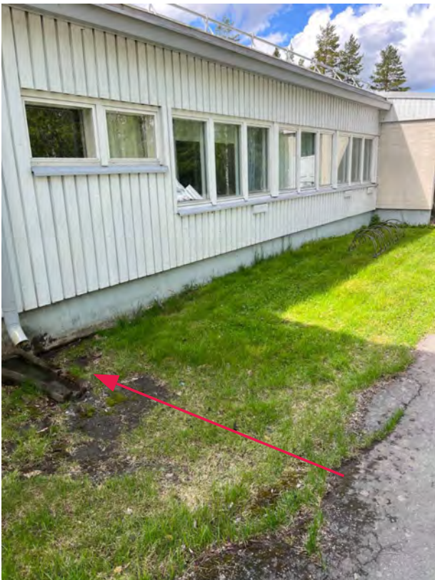
Kuva 23. Vesi lammikoituu seinän vierustalle
