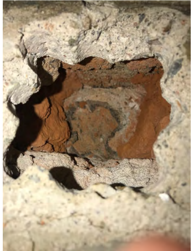
Tiilimuurauksen alla pikisively ja toinen betonilaatta.
