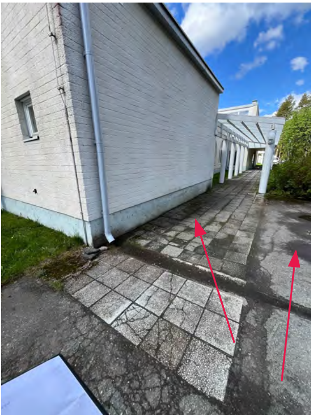
Kuva 7. Vesi lammikoituu seinän vierustalle
