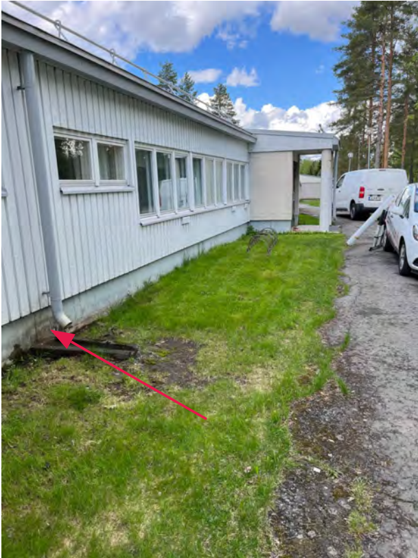
Kuva 5. Maanpinnan kallistukset heikot. Sadevedet roiskuvat sokkelia vasten
