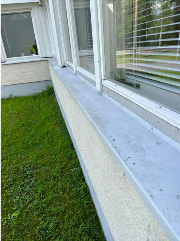
Kuva 21. Ikkunapeltien kallistukset heikot osalla ikkunoista
