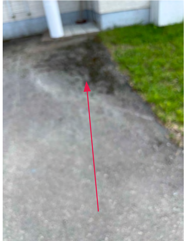
Kuva 22. Vesi lammikoituu seinän vierustalle
