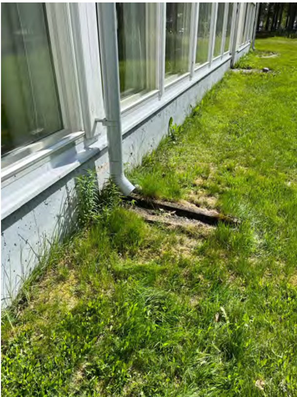
Kuva 15. Vesi lammikoituu seinän vierustalle
