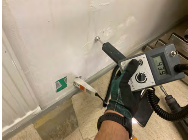
Seinän kosteusjäljet kuivuneita
