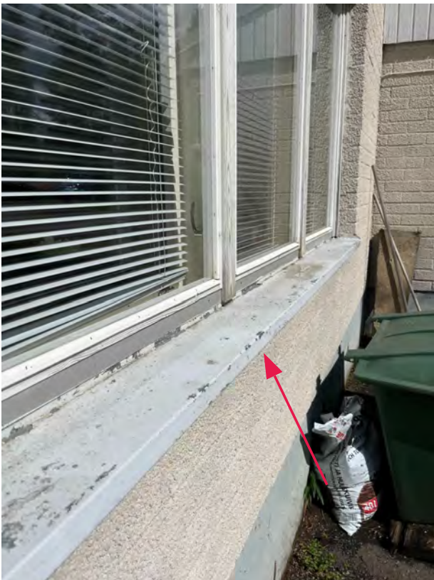
Kuva 11. Ikkunapeltien kallistukset heikot osalla ikkunoista
