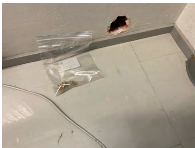
Mikrobiinäyte 1, ulkoseinän lastuvillalevy
