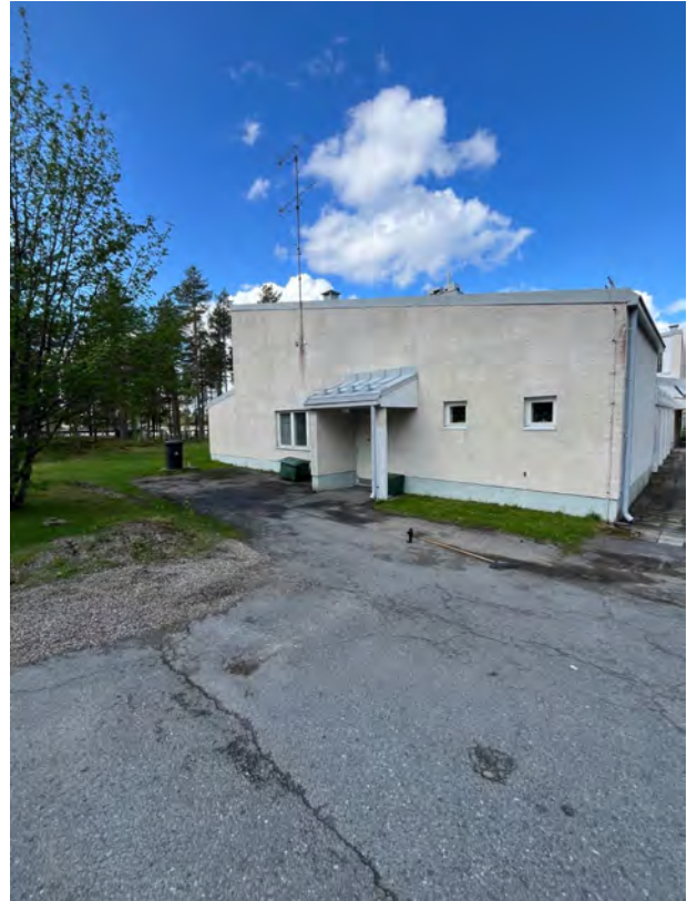
Kuva 10. Maanpinnan kallistukset heikot.
