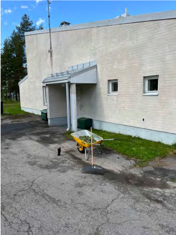
Kuva 9. Maanpinnan kallistukset heikot.
