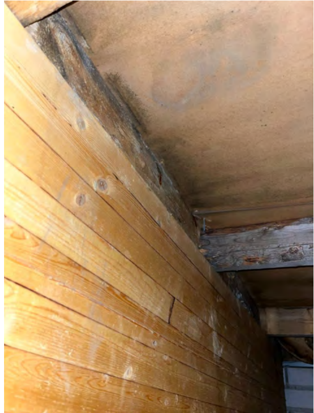
Kuva 30. Aluskate kostunut ja kostuttanut puuosia (huone nro 24)
