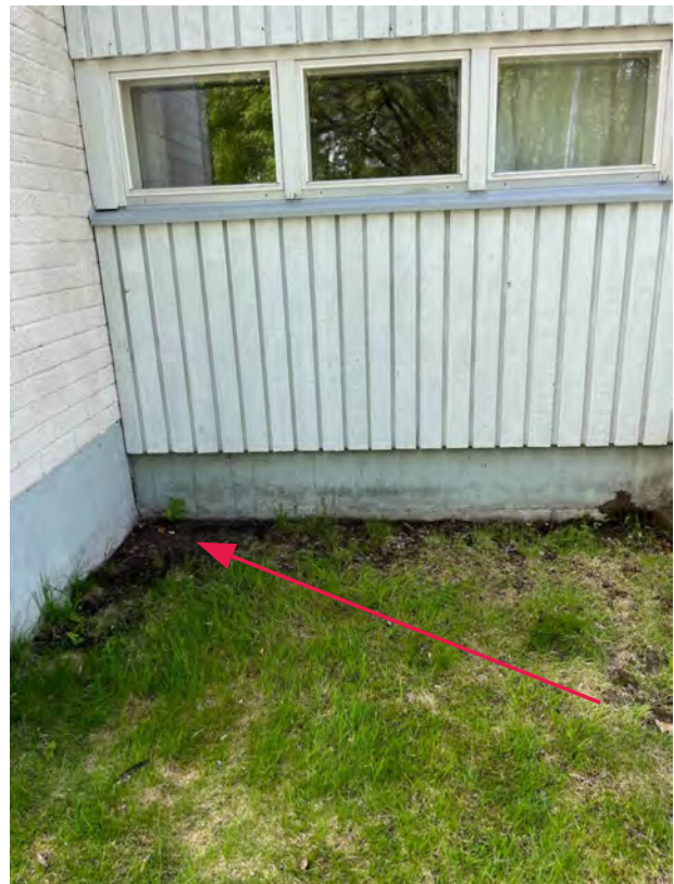
Kuva 24. Kosteita seinän vierustoja
